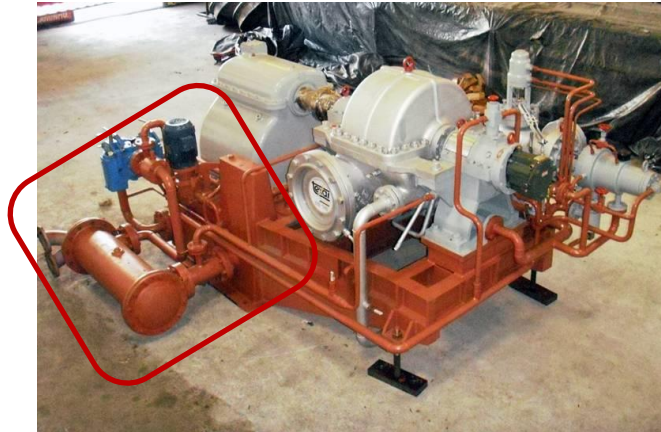
Figura 4 – Vaso de pressão de sistema de lubrificação de turbinas a vapor no mesmo skid da turbina
